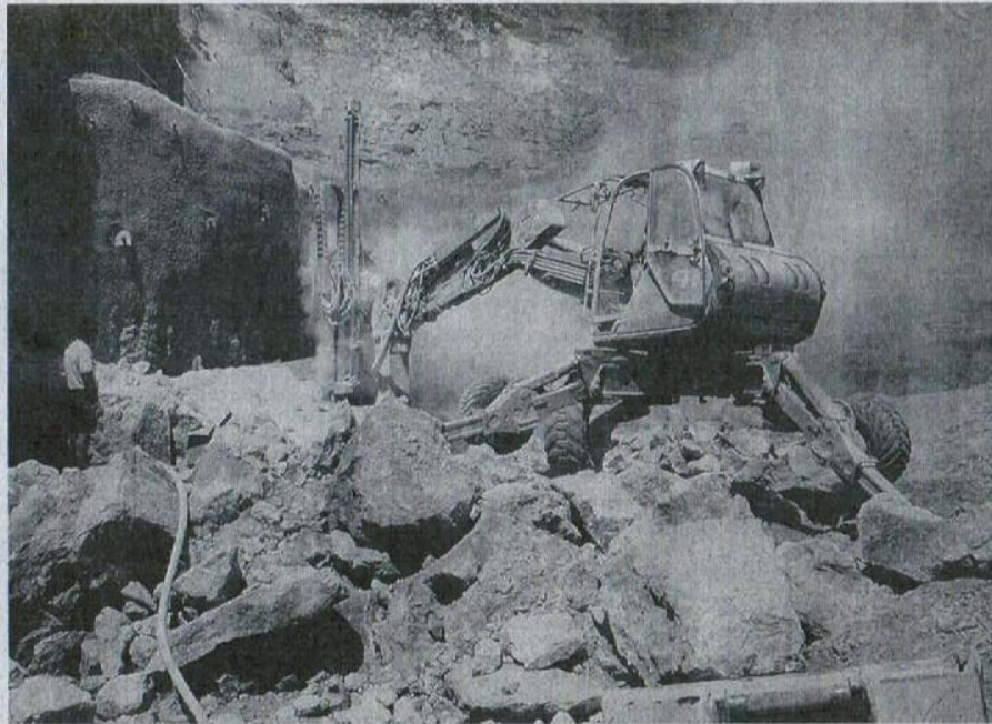
Die Bohrungen mit einem Durchmesser von 40 mm wurden mit einer speziellen Bohrlafette ausgeführt, die relativ geringe Erschütterungen brachte. Fotos: Bau-Haag
